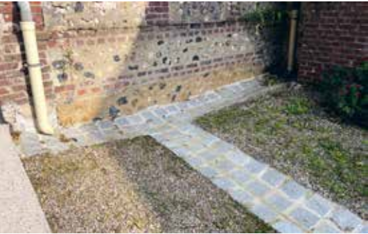
Un caniveau pavé permet de diriger l'eau des gouttières loin des pieds de murs de l'église pour éviter les dégradations des appareillages de maçonnerie.
