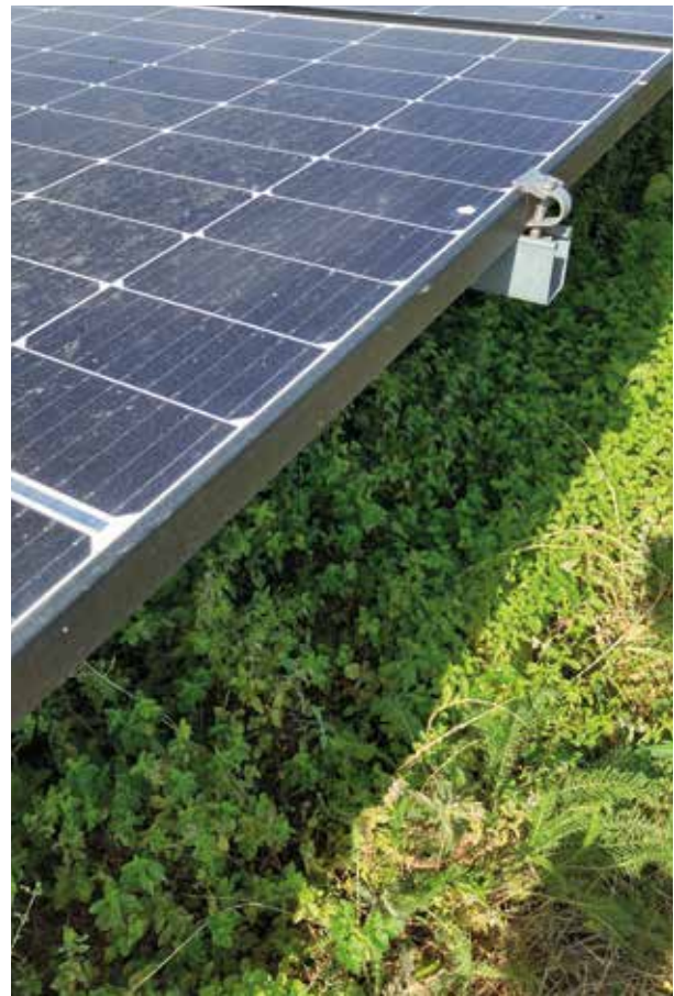
Sur la toiture du Stream building, les plantes cohabitent sous les panneaux solaires © Topager
